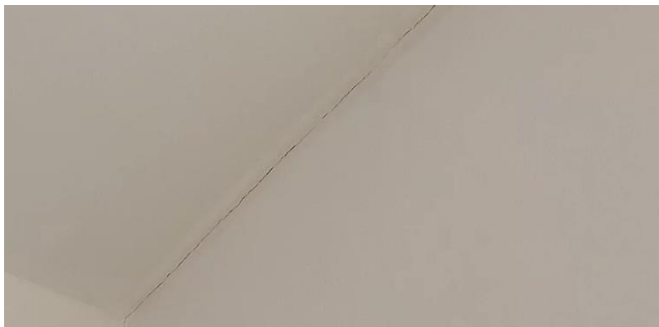
Foto af eksempel på bevægelsesrevne mellem væg og loft.
